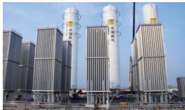
南阳茶庵建成LNG储配站
